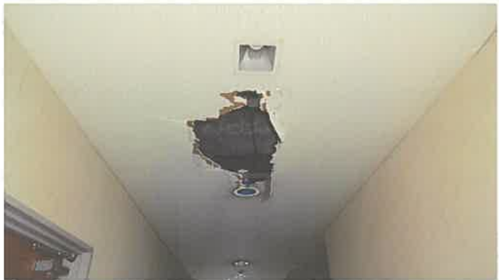
前同 (天井の一部が崩落)
