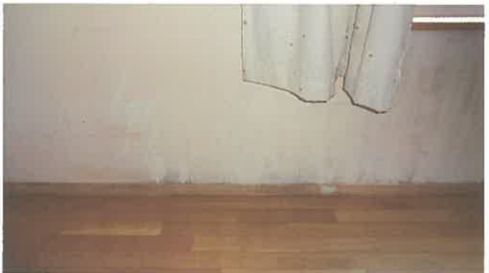
前同（内壁の広範囲の汚れ）
