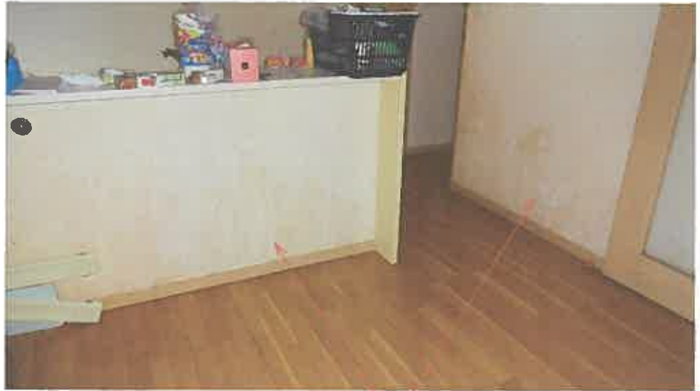
前同 (内壁の広範囲の汚れ)
