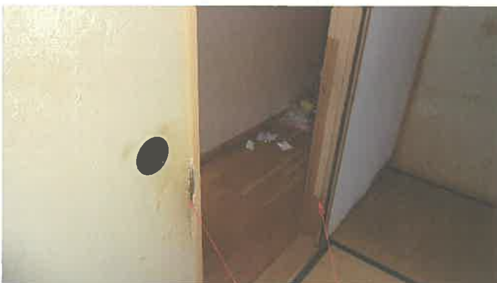
前同 (建具の汚れや建具枠の破損)
