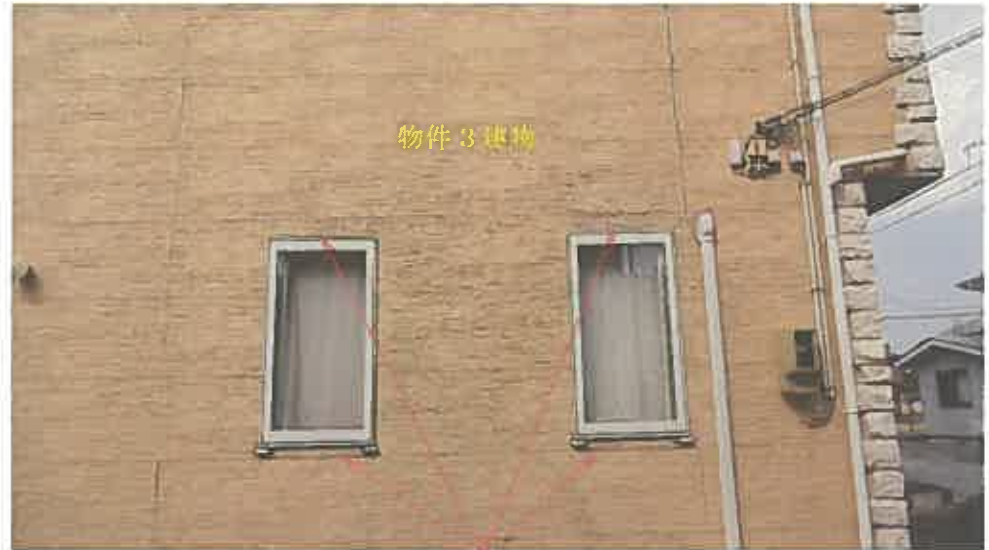
外壁塗装の剥離・損傷
