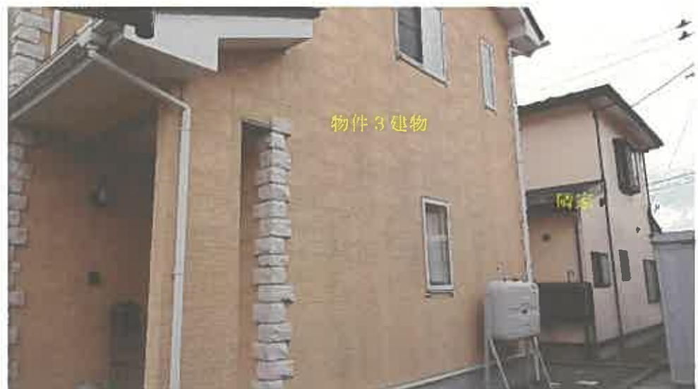
外壁のうっすらとした黒ずみ
