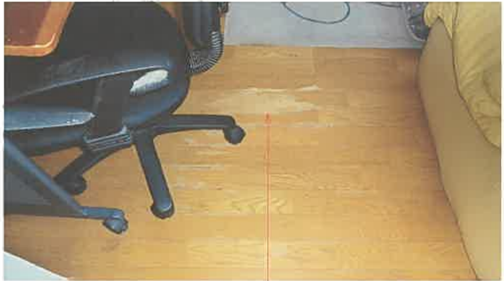
前同 (フローリング表面の損傷)
