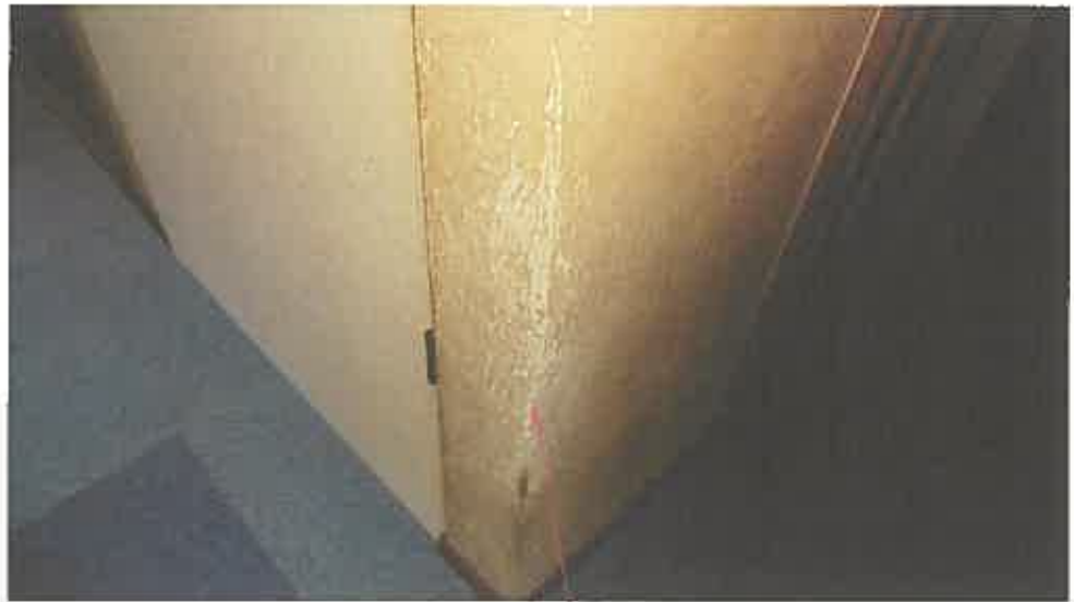
前同 (猫による損傷)
