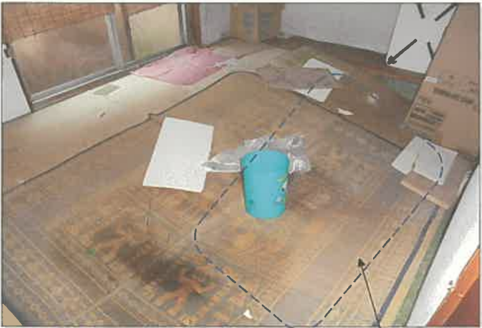
床が陥没している。
