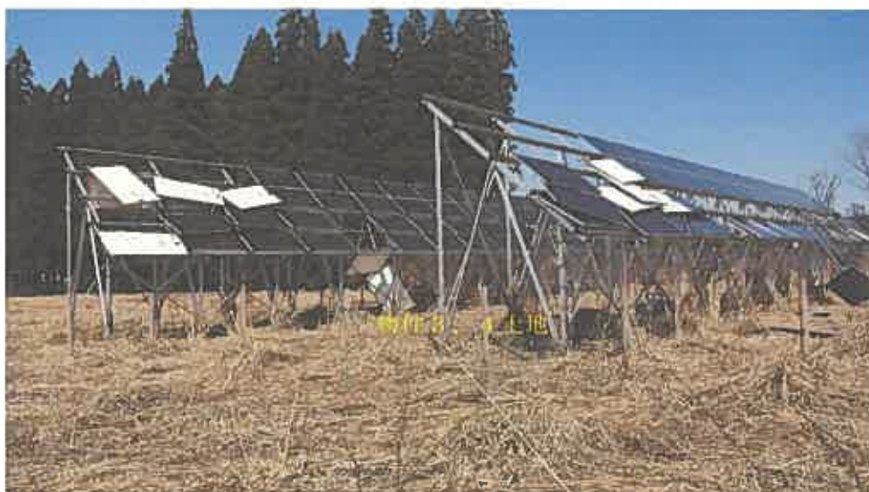
ソーラーパネルの破損・落下状況
