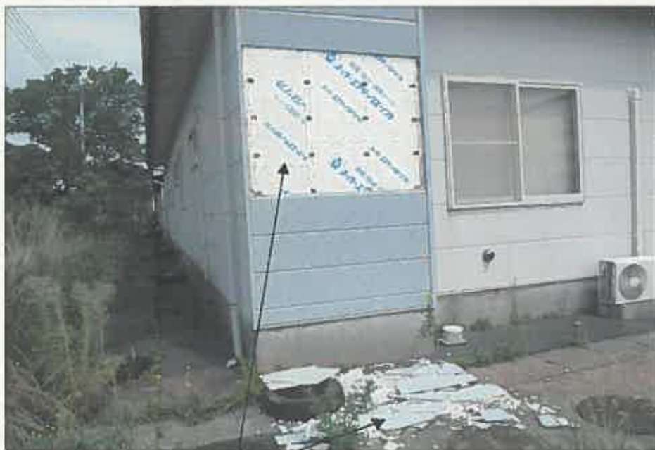
外壁の剥離 ( 10 枚目)
