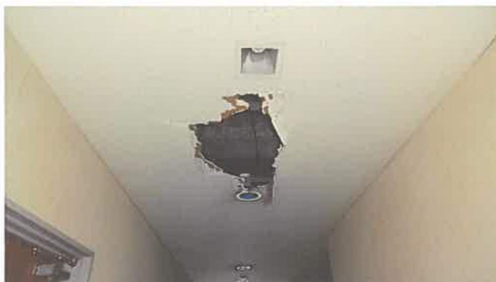
前同（天井の一部が崩落）
