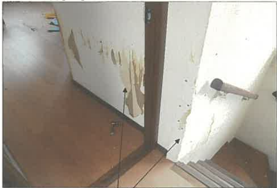
内壁クロスの損傷 ( 15 枚目)
