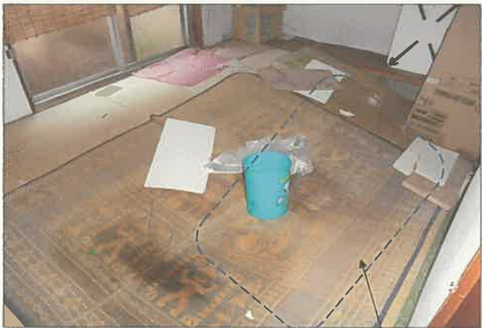
床が陥没している。
