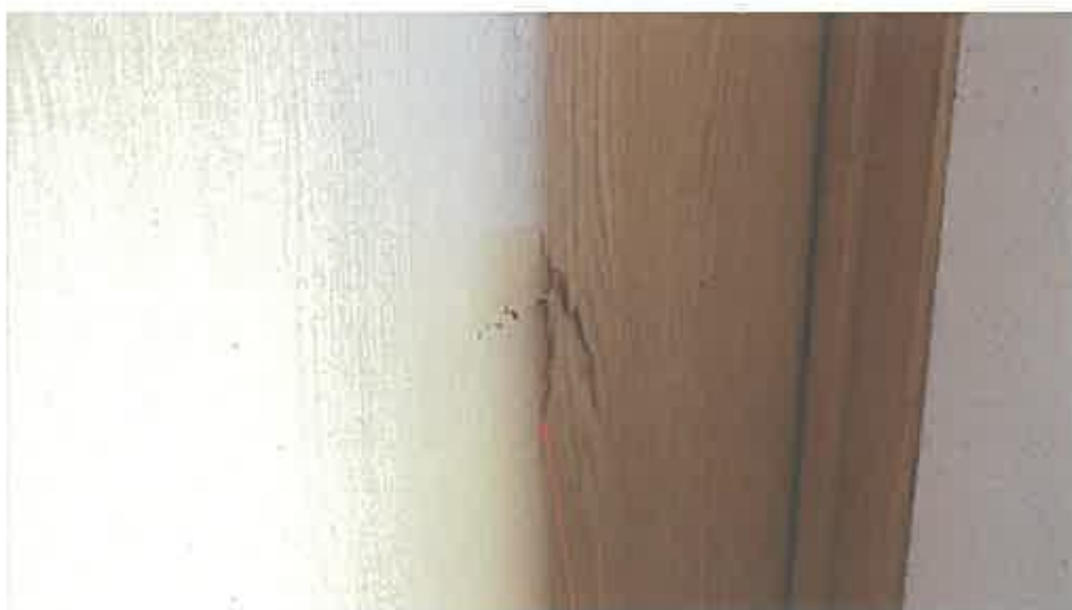
前同（ドアの破損部分）
