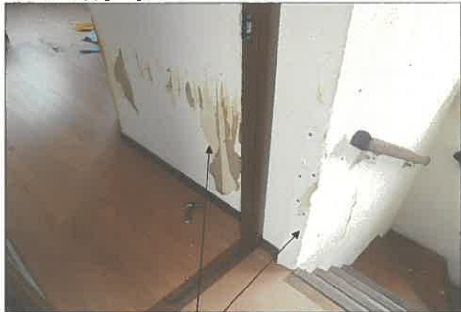
内壁クロスの損傷 ( 15 枚目)
