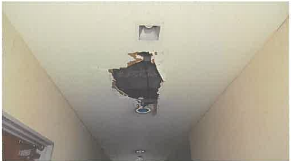
前同（天井の一部が崩落）
