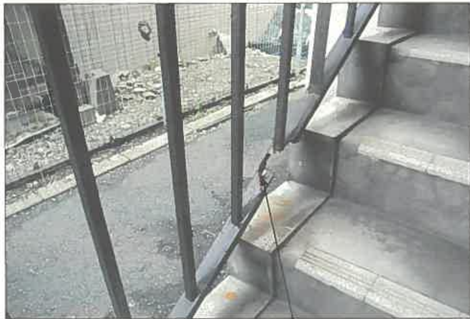
手すりの腐食
