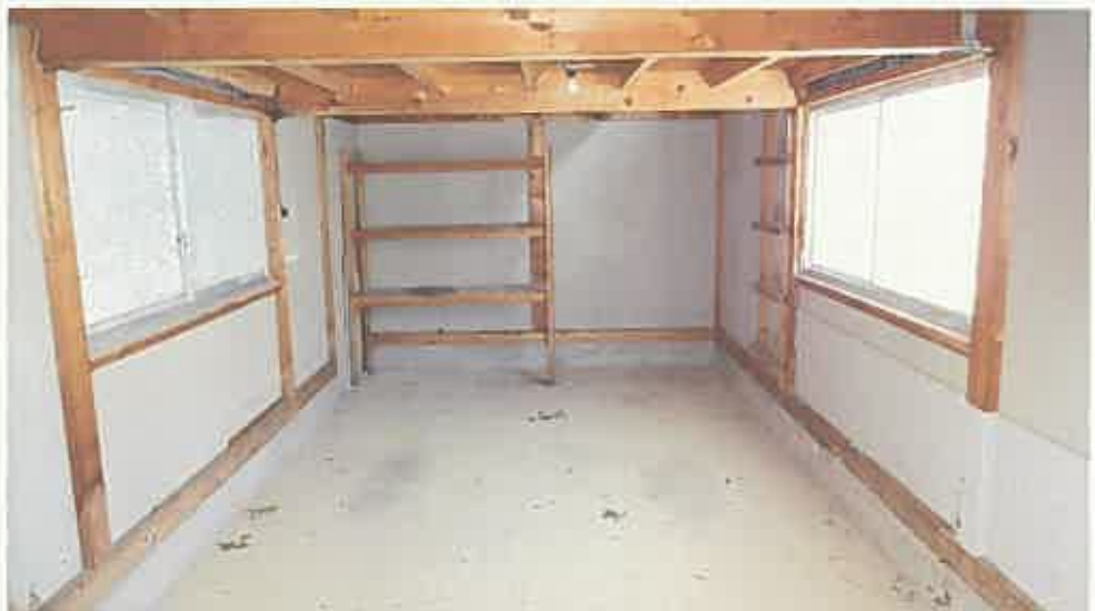
物件 2 未登記附属建物内部の状況（1 階）
