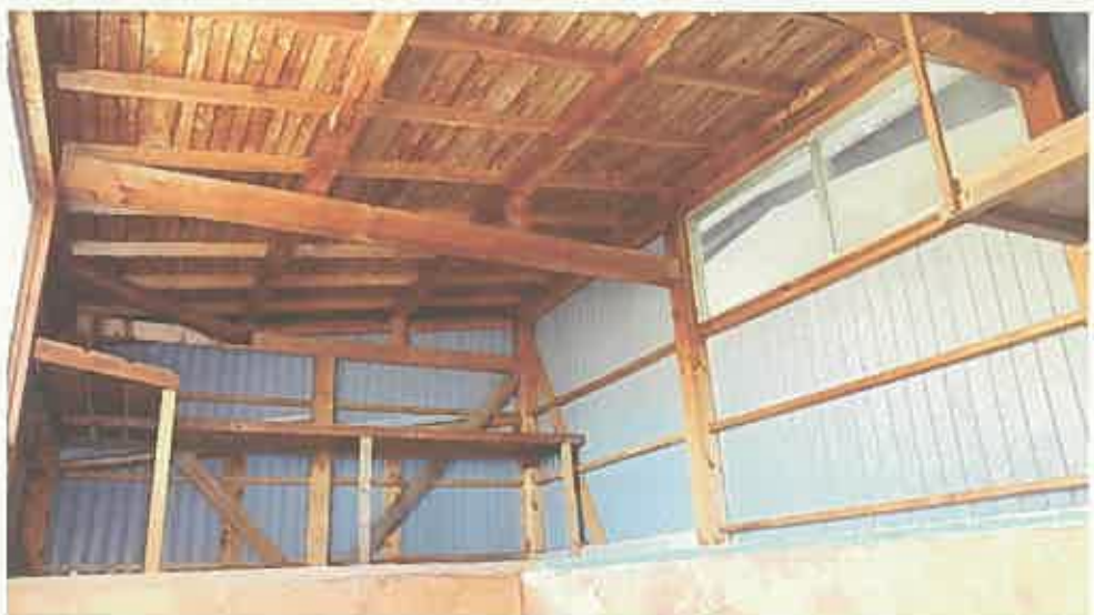
物件 2 未登記附属建物内部の状況（2 階）
