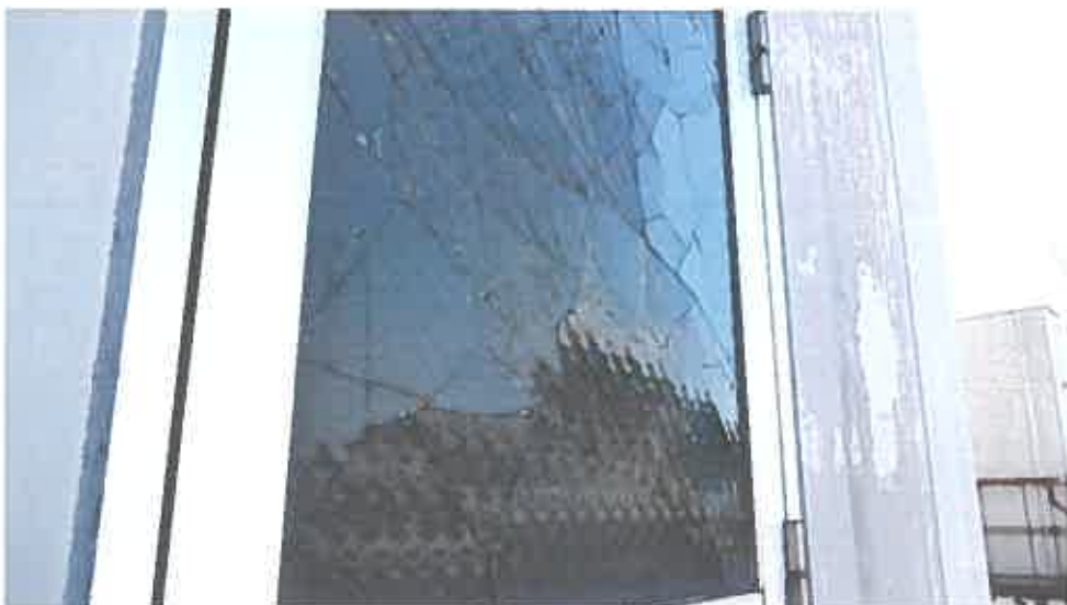
前同（ドアガラスが割れている）
