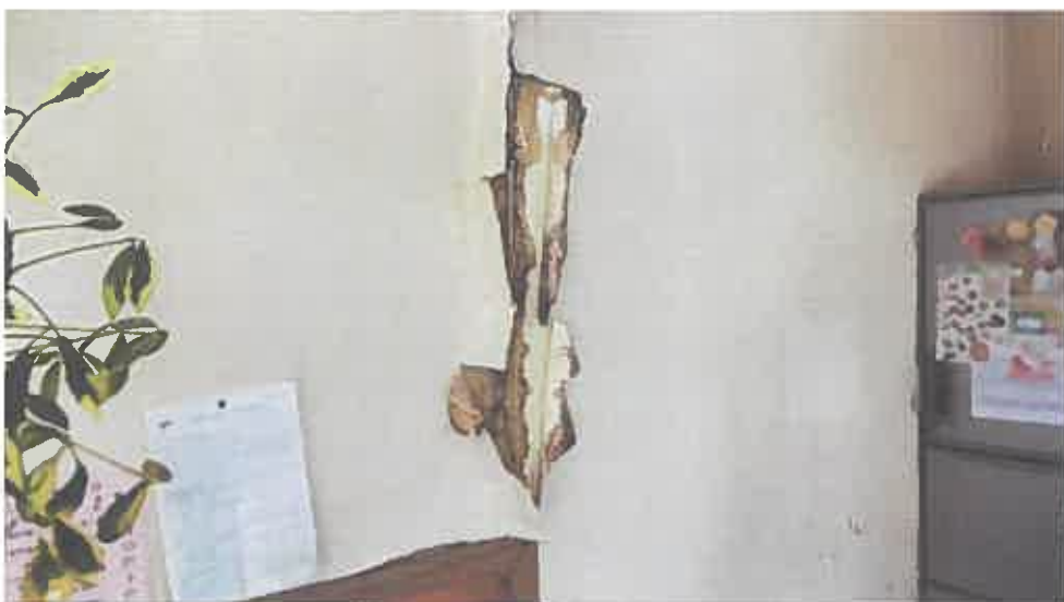
前同（雨漏りによる内壁の剥離）
