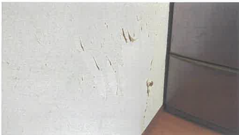
前同（猫による内壁の損傷）
