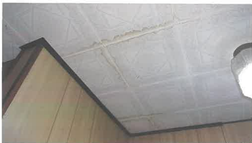
前同（雨漏り跡）
