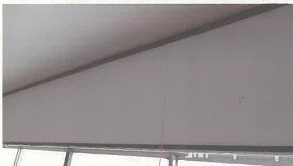
前同（クロスの亀裂）
