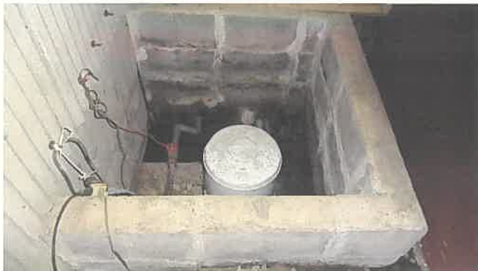
前同 (ポンプ室)
