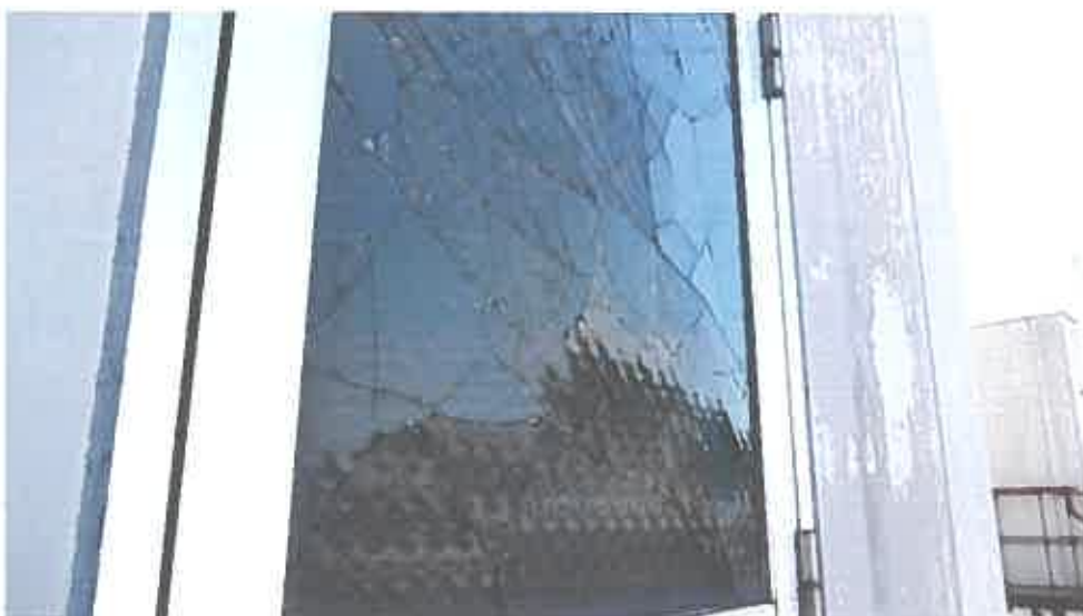
前同（ドアガラスが割れている）
