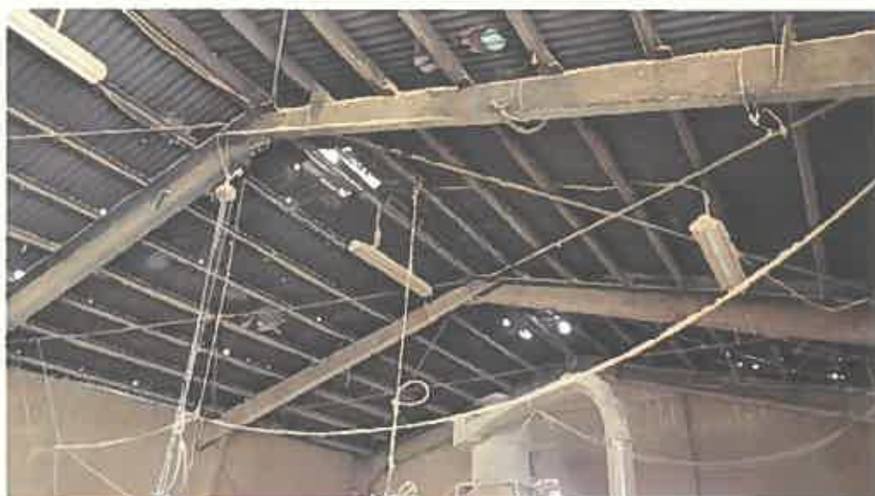
前同（屋根の腐食穴多数）
