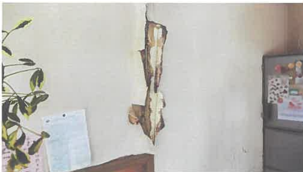
前同（雨漏りによる内壁の剥離）
