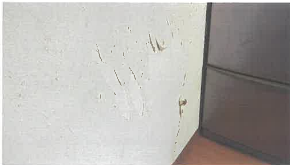
前同（猫による内壁の損傷）
