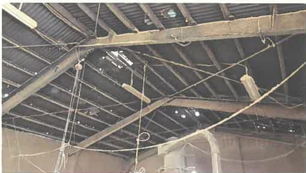
前同（屋根の腐食穴多数）
