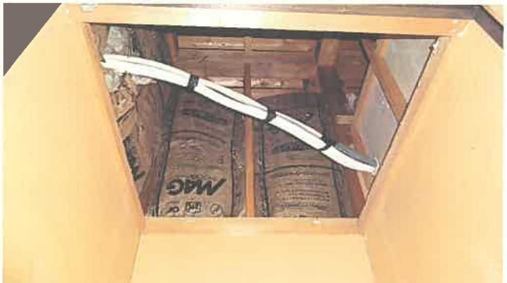
前同（収納の天井が抜け落ちている）
