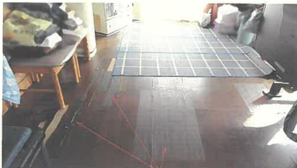
前同 (床の損傷)
