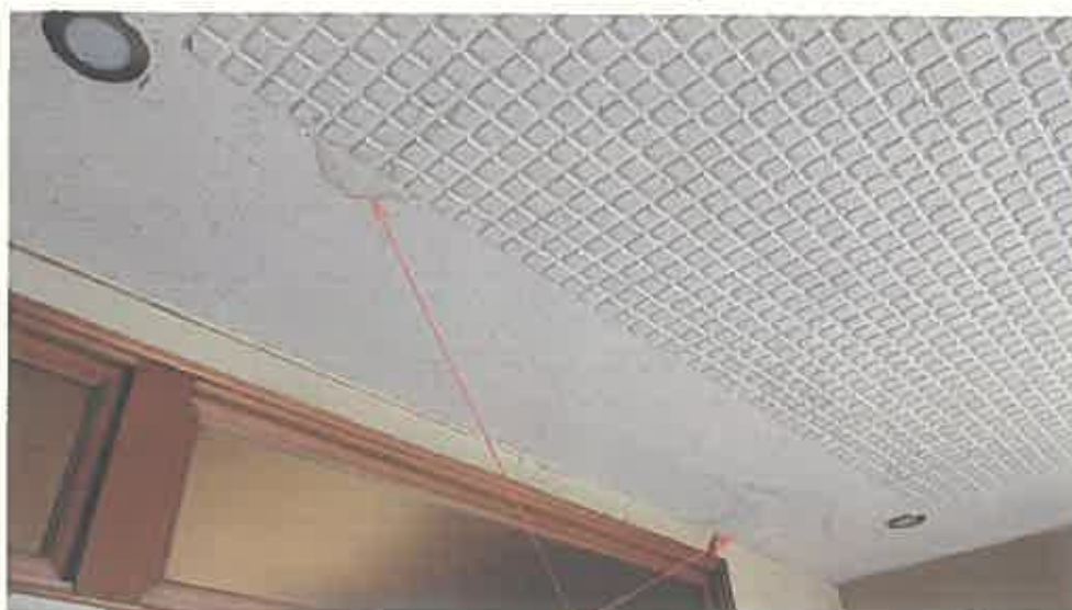
前同 (天井の滲み)
