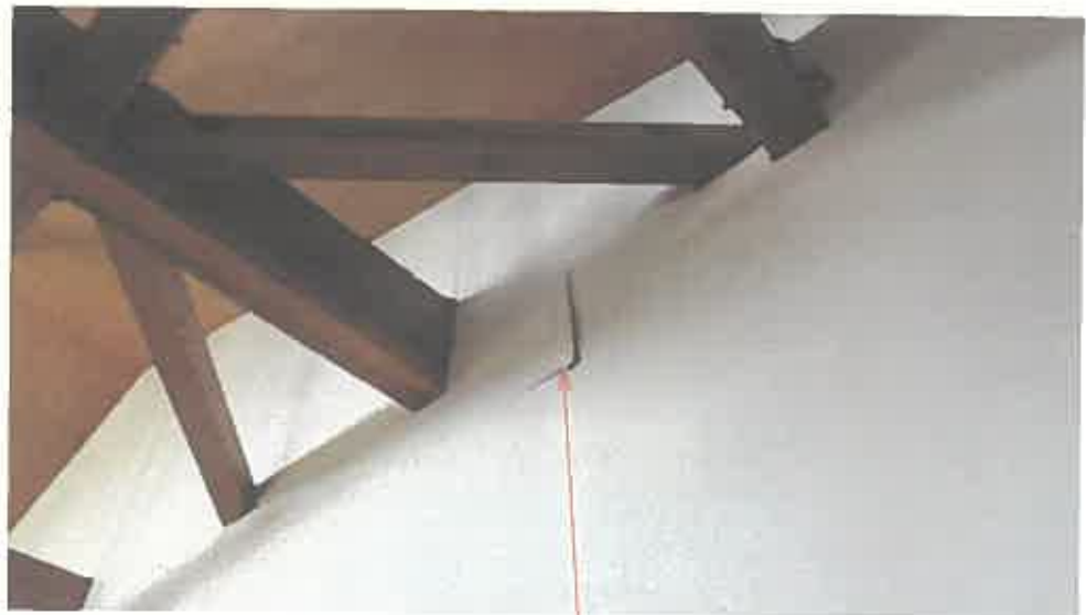
前同 (内壁の亀裂)
