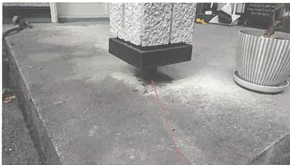
玄関入口屋根の支柱（金属部分腐食）
