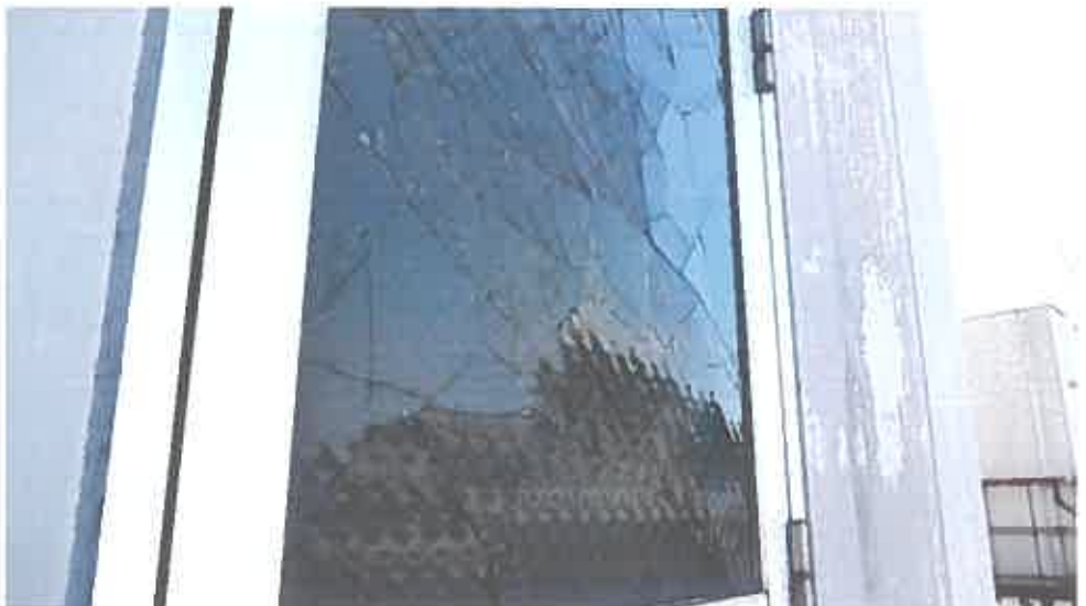
前同（ドアガラスが割れている）
