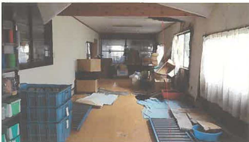
(天井の崩落 (雨漏り))
