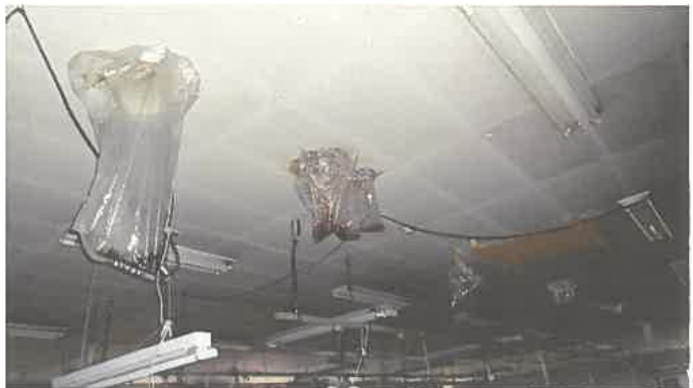
前同（天井の雨漏り）
