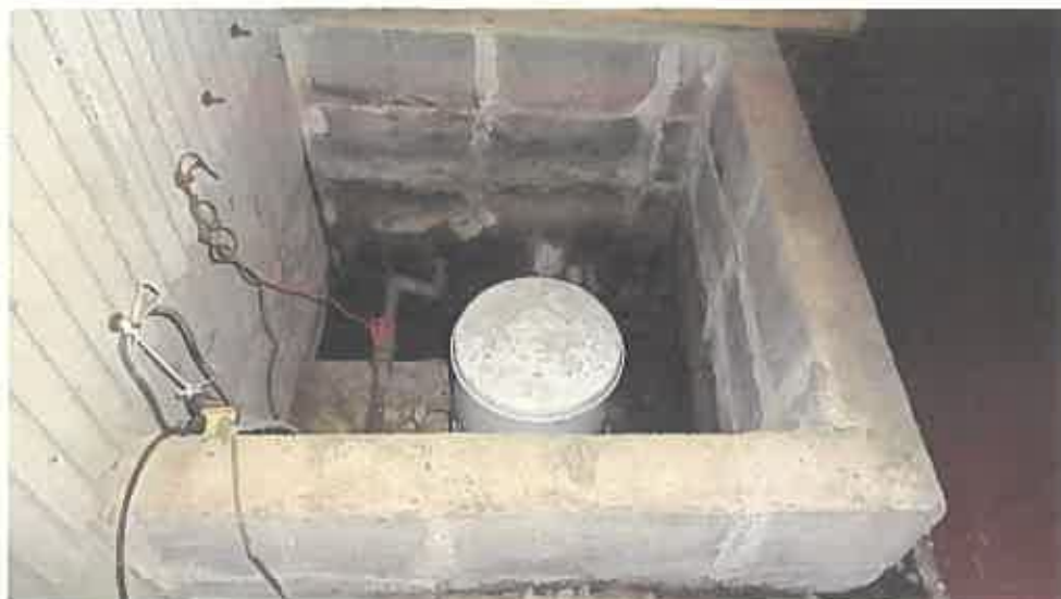
前同 (ポンプ室)
