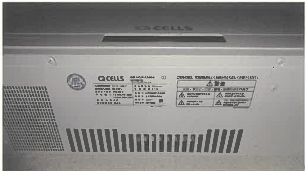
物件 2 主である建物に設置されている太陽光発電設備 (パワーコンディショナ)
