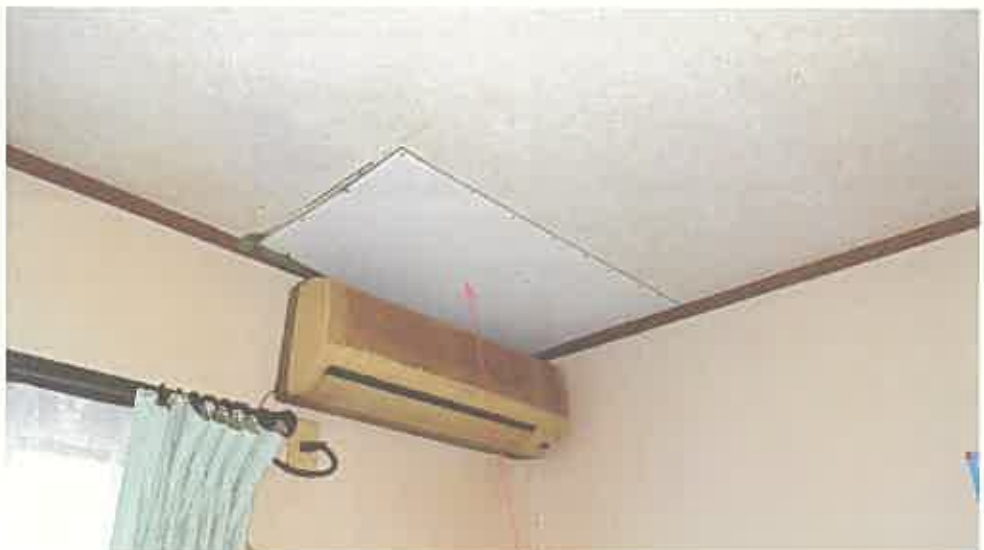
前同 (天井の補修跡)
