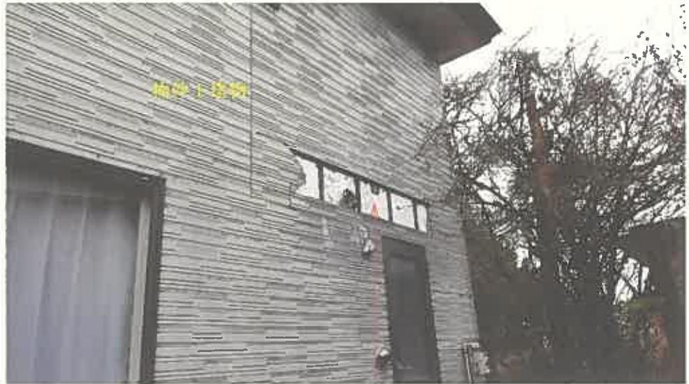
外壁の剥がれ
