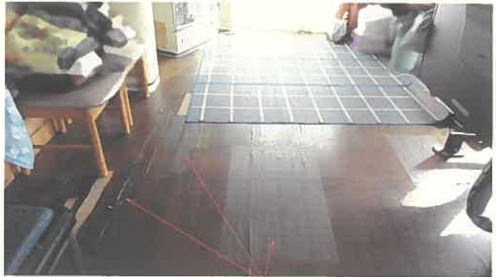
前同 (床の損傷)
