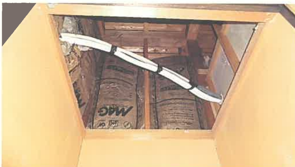
前同 (収納の天井が抜け落ちている)
