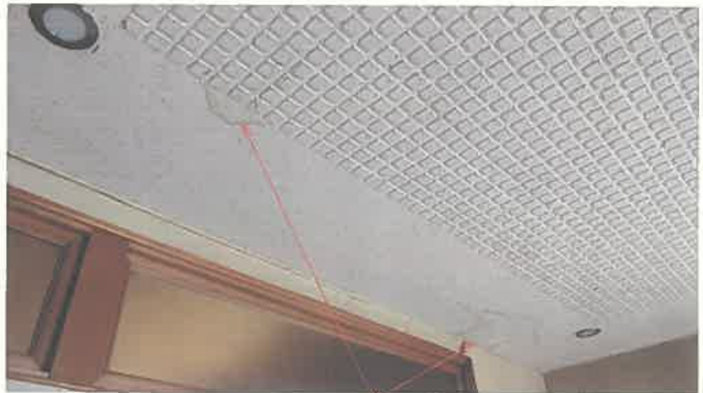
前同 (天井の滲み)
