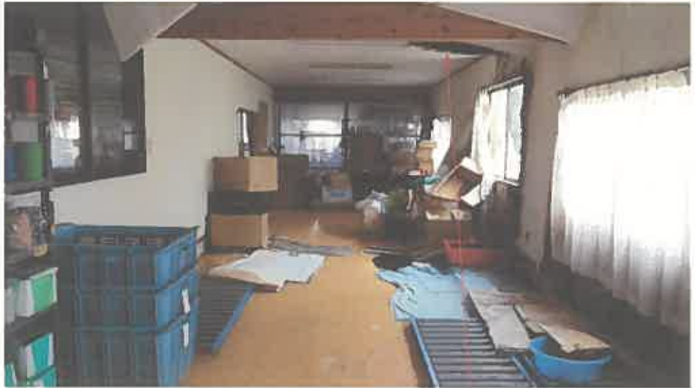
(天井の崩落 (雨漏り))
