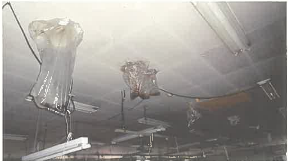
前同 (天井の雨漏り)
