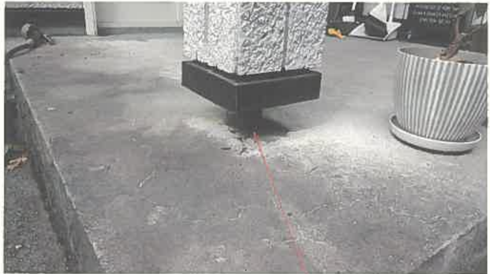
玄関入口屋根の支柱（金属部分腐食）
