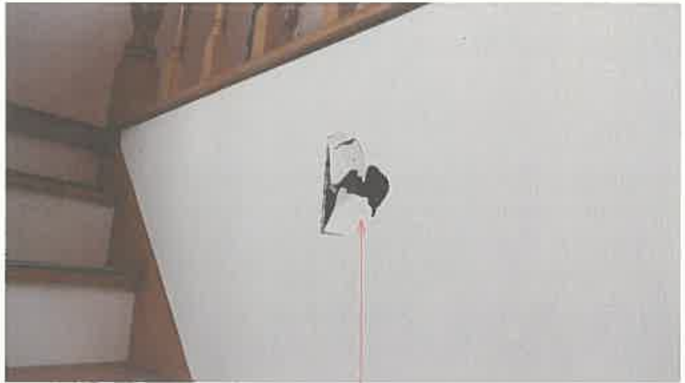
前同（内壁に穴が空いている）
