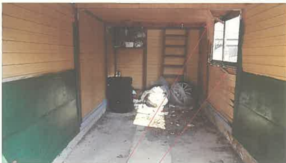
前同（天井及び内壁の破損）
