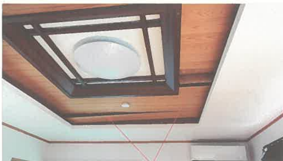
前同（天井板が一部外れている）
