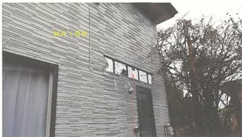
外壁の剥がれ
