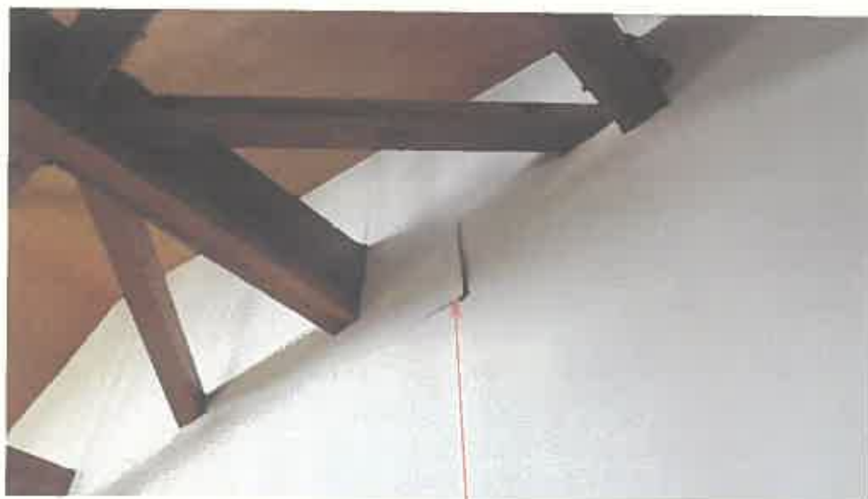
前同 (内壁の亀裂)
