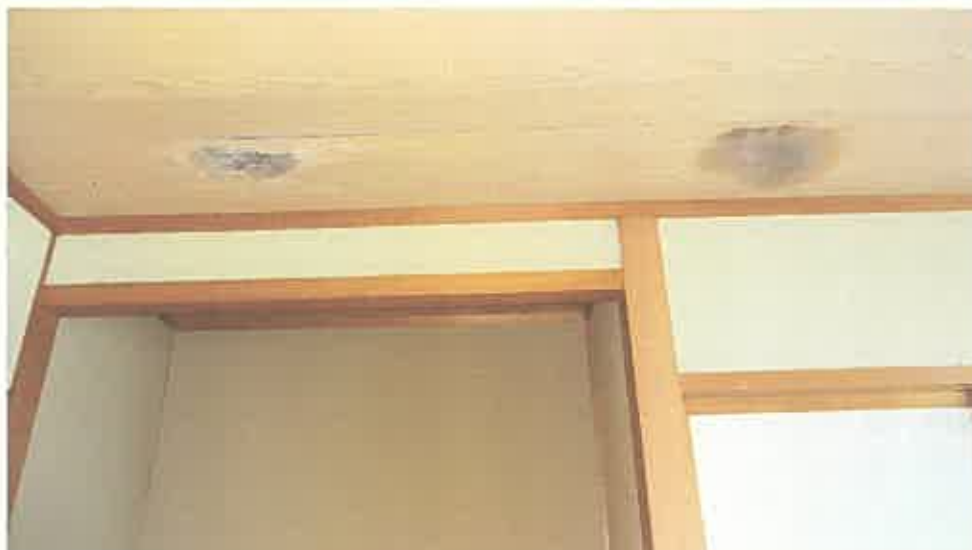
前同（天井の雨漏り跡）
