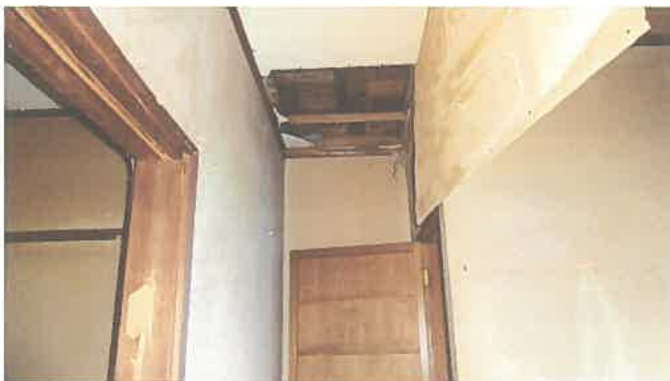
前同 (天井板が一部崩落)
