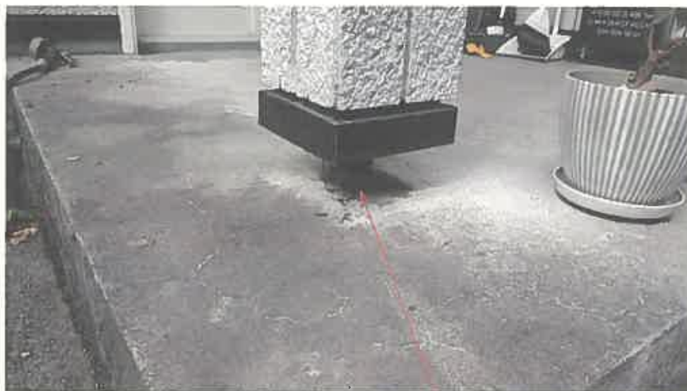
玄関入口屋根の支柱（金属部分腐食）
