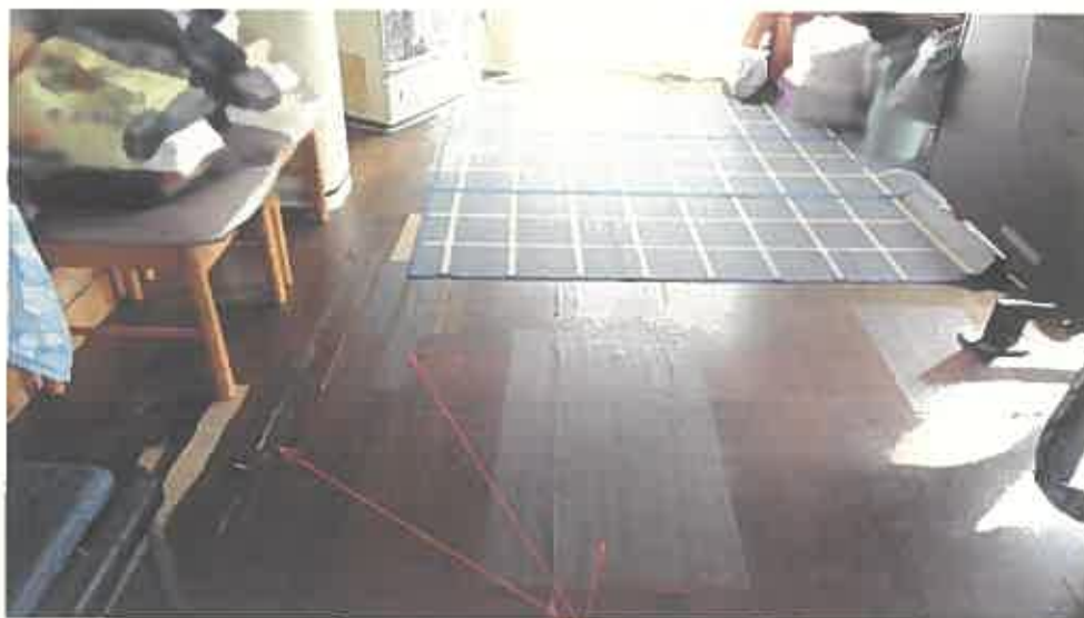
前同（床の損傷）
