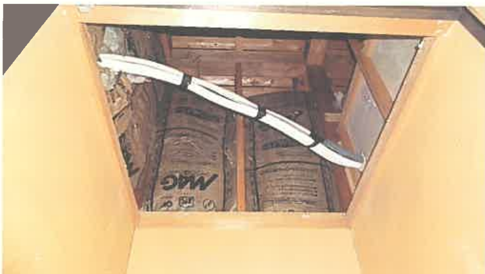
前同（収納の天井が抜け落ちている）
