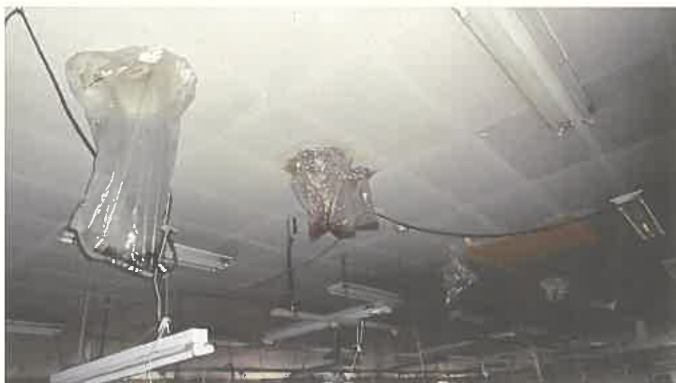
前同 (天井の雨漏り)
