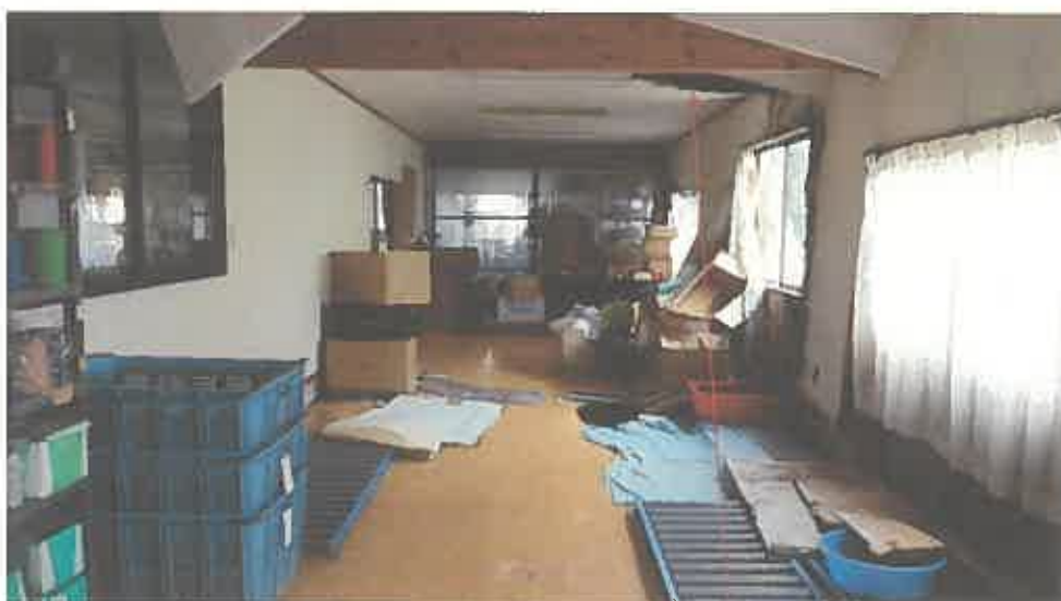
(天井の崩落 (雨漏り))
