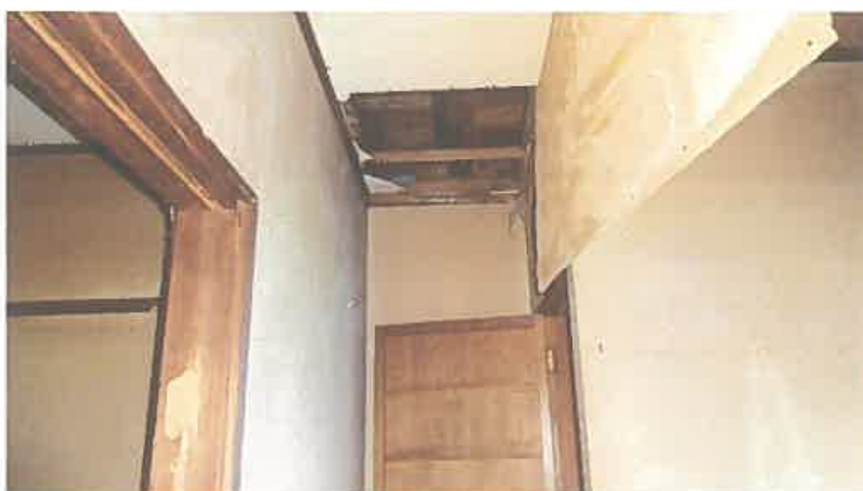
前同（天井板が一部崩落）
