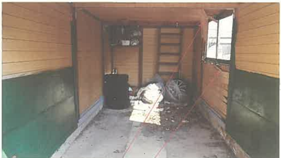
前同（天井及び内壁の破損）
