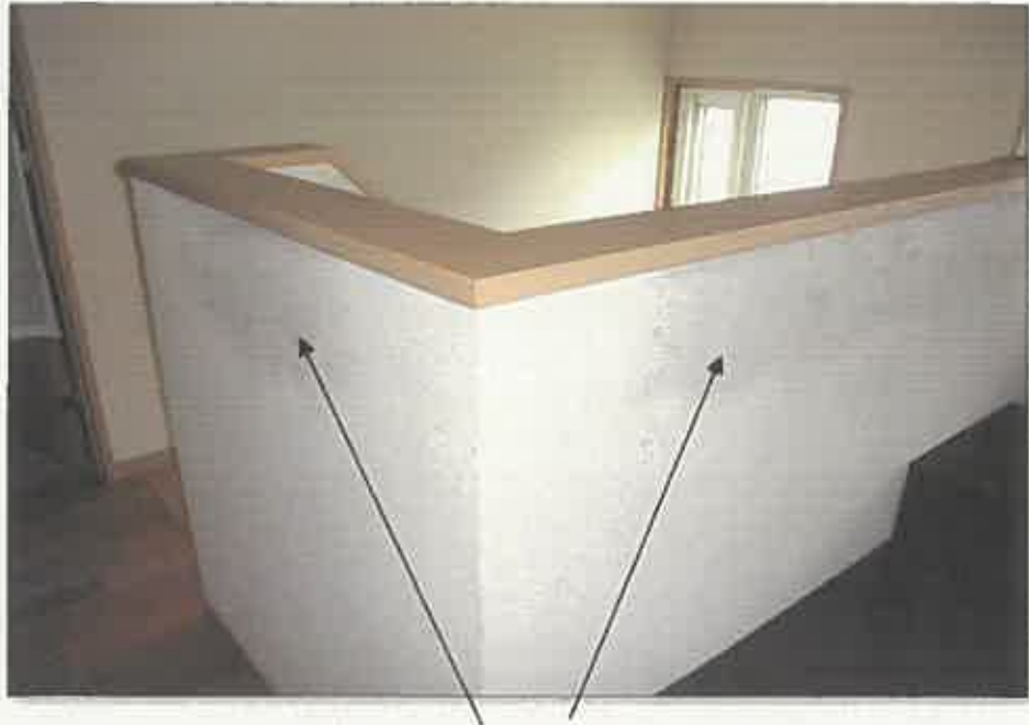
カビのような汚れが付着している。
