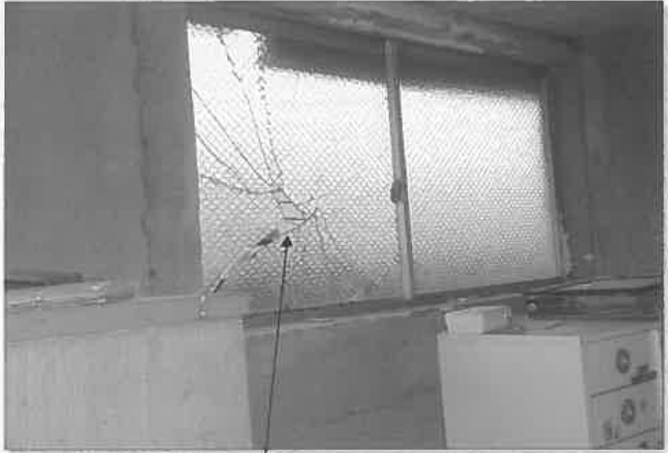
窓ガラスが割れている。
