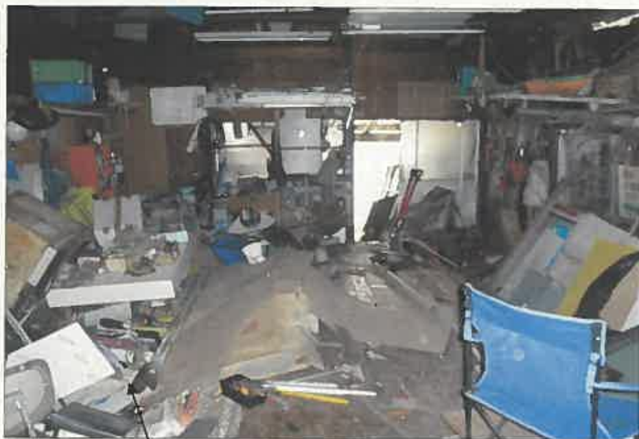
床が抜けている。
