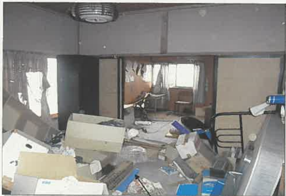
部屋の中央に向かって沈み込んでいる。 ( 11 枚目)
