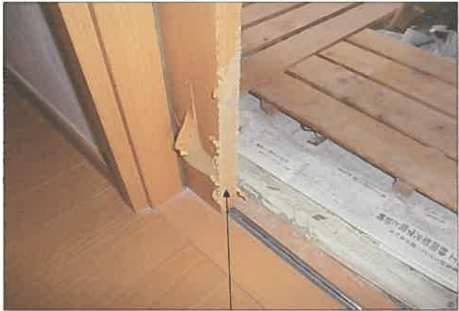
建具の損傷 ( 10 枚目)
