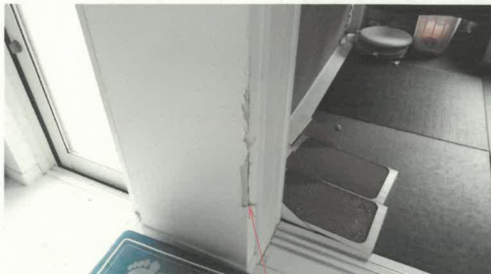
前同 (猫による内壁クロスの損傷)
